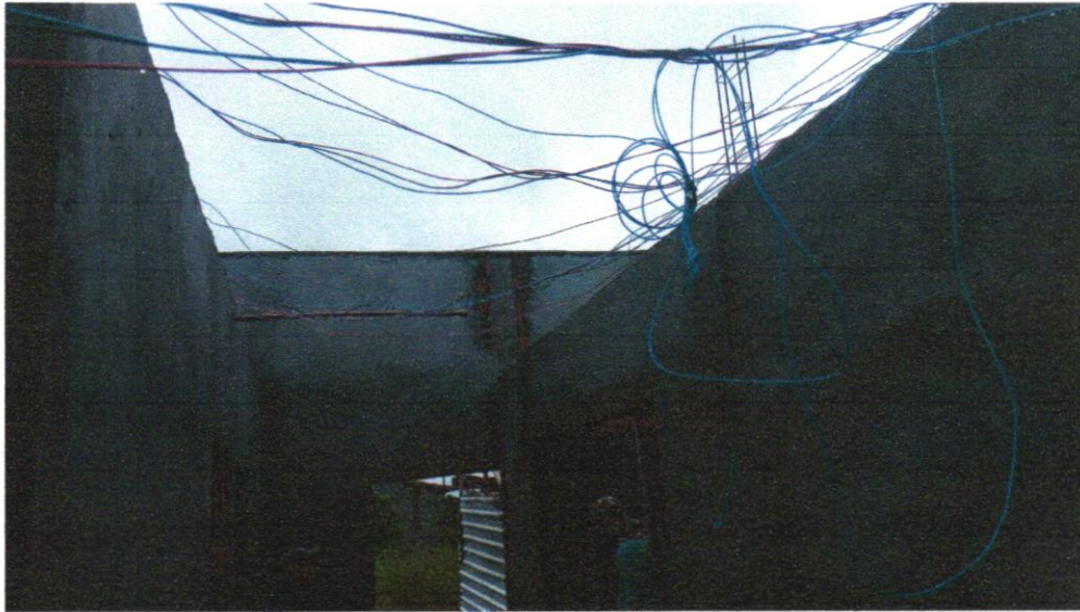
Foto 21 - CABO DE COBRE FLEXÍVEL ISOLADO, 4 MM 2 , ANTI-CHAMA 450/750 V, PARA CIRCUITOS TERMINAIS - FORNECIMENTO E INSTALAÇÃO. AF_12/2015
