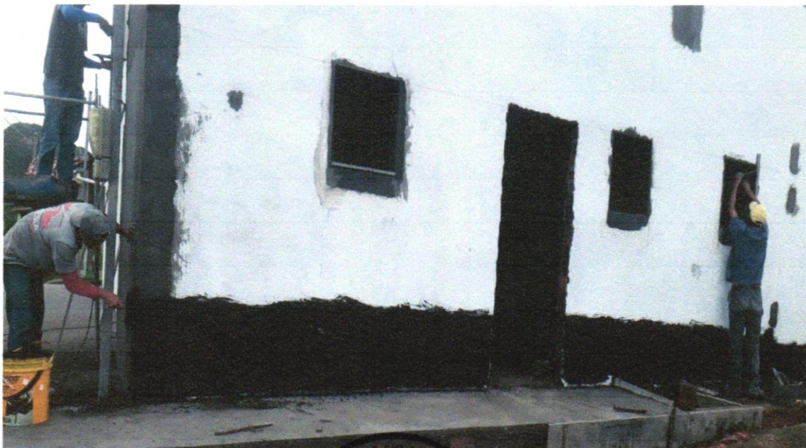
Foto - 34 - IMPERMEABILIZAÇÃO DE SUPERFÍCIE COM MANTA ASFÁLTICA, UMA CAMADA, INCLUSIVE APLICAÇÃO DE PRIMER ASFÁLTICO, E=3MM. AF_06/2018
