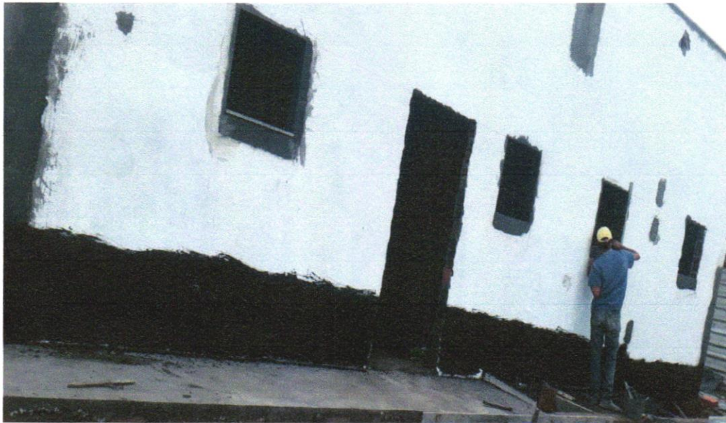
Foto 33 - IMPERMEABILIZAÇÃO DE SUPERFÍCIE COM MANTA ASFÁLTICA, UMA CAMADA, INCLUSIVE APLICAÇÃO DE PRIMER ASFÁLTICO, E=3MM. AF_06/2018
